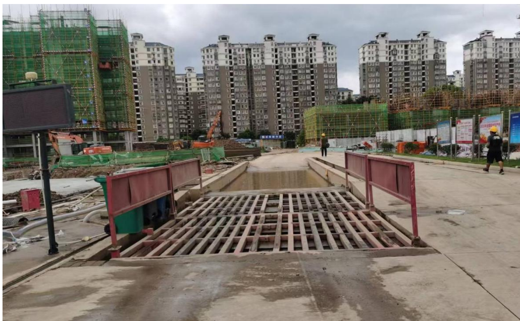
图 3-2 洗车槽现场照片
