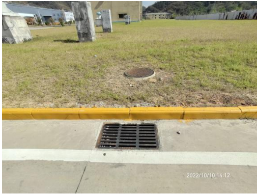
雨水口及集水井
