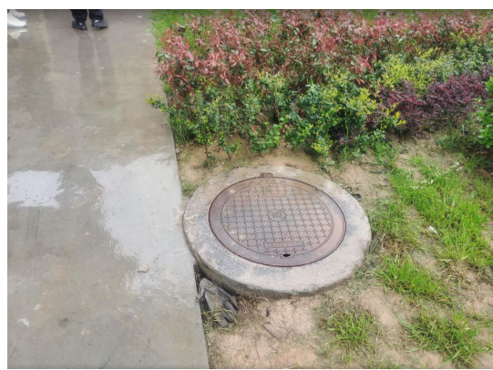
2023 年第一季度雨水井运行情况
