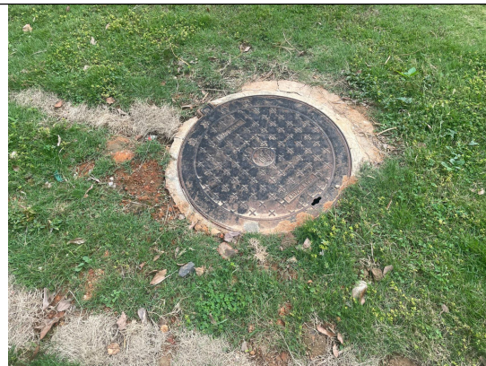
2023 年 9 月雨水井运行情况
