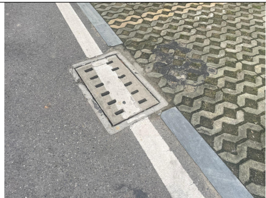
2023 年 9 月雨水口运行情况
