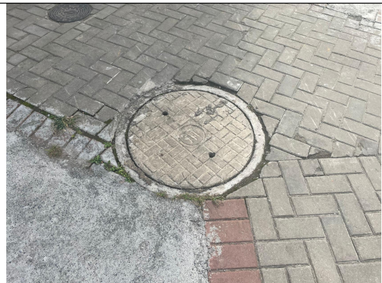
2023 年 9 月雨水井运行情况
