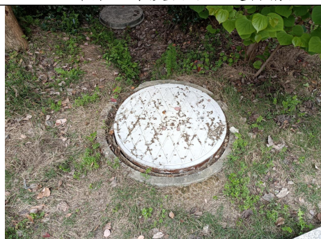
2023 年第三季度雨水井运行情况
