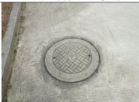
2023 年第三季度雨水井运行情况
