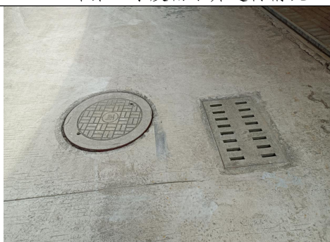
2023 年第三季度雨水井运行情况
