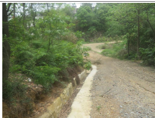
2023 年第二季度排水沟运行情况
