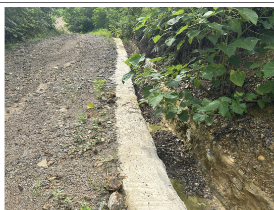
2023 年第二季度排水沟运行情况
