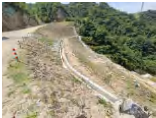
弃土场截、排水沟
