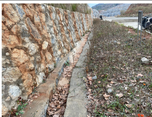
2022 年第四季度排水沟运行情况
