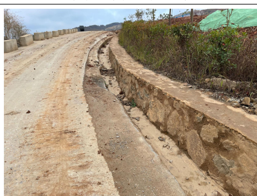
2022 年第四季度排水沟运行情况
