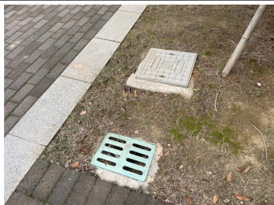
雨水井、雨水口
