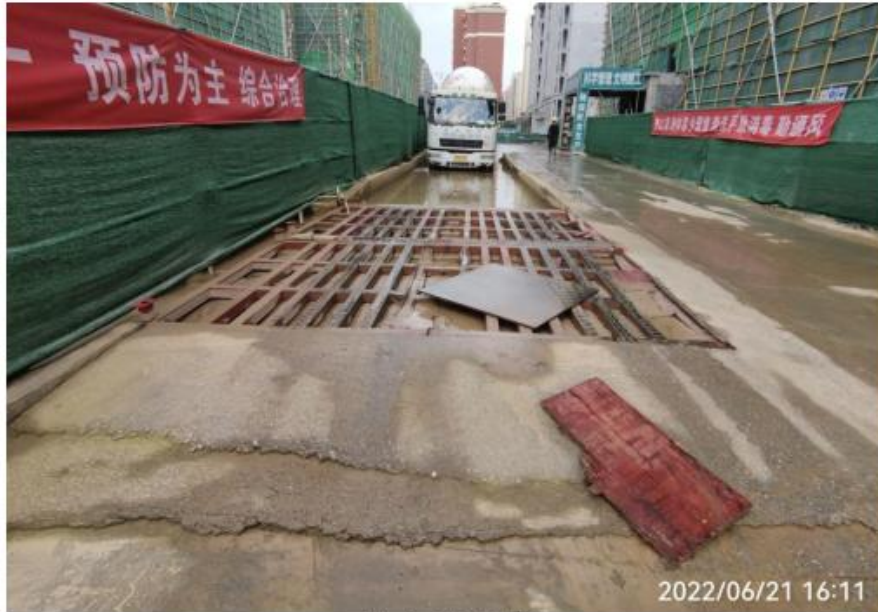
洗车槽及临时围挡
