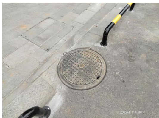
2022 年第三季度雨水井运行情况
