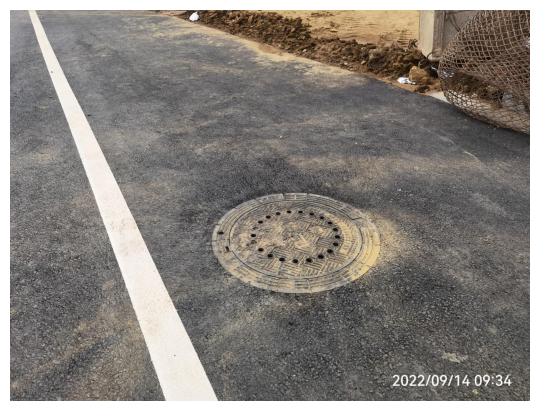
2022年第三季度雨水井运行情况
