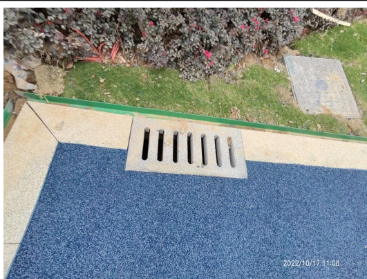
2022 年第四季度雨水井运行情况
