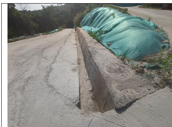
2022 年第二季度排水沟运行情况
