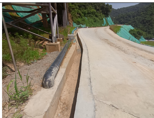
2022 年第二季度排水沟运行情况
