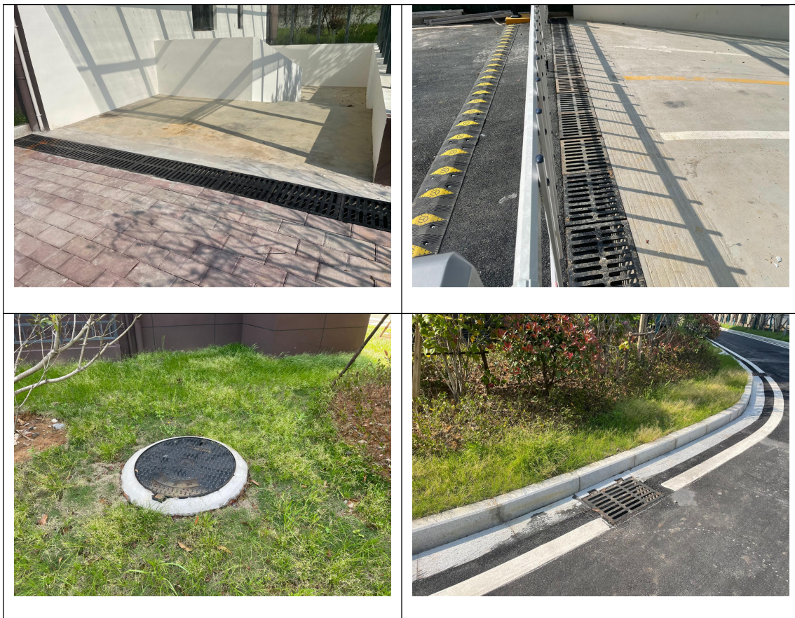
排水沟雨水口雨水井运行情况
