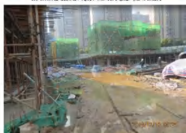
项目区内场地积水，建议尽快排水排干，避免影响工程进度
