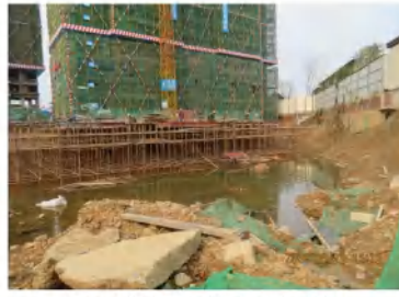
项目区内场地积水严重建议尽快排水清淤，避免加剧工程难度
