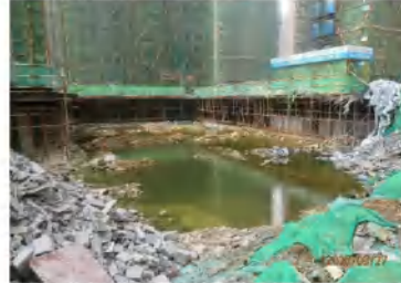
项目区内场地积水严重建议尽快排水疏通，避免影响工程进度
