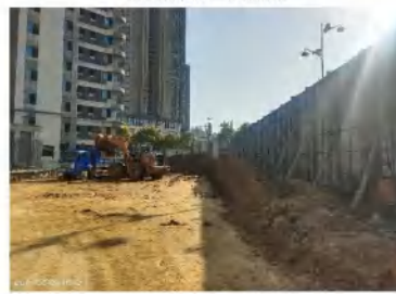
临时堆土裸露，未采取防护措施
