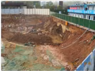
项目区内临时堆土及开挖边坡裸露，建议采取临时防护措施，减少水土流失
