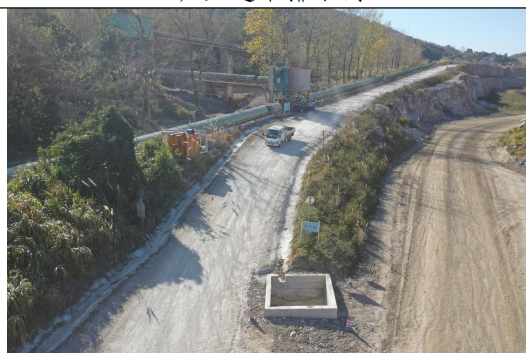
矿区道路沉砂池
