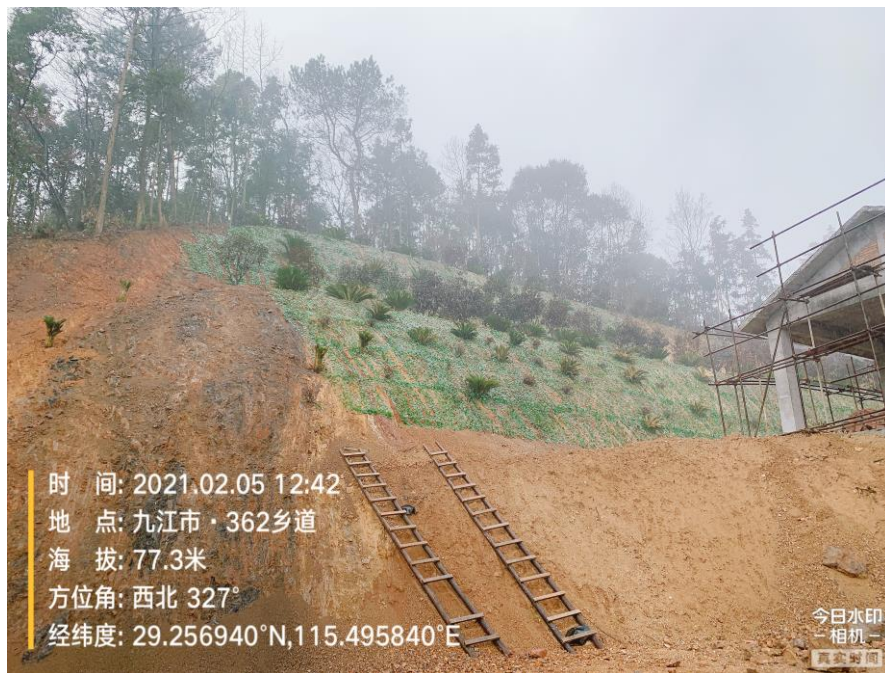
边坡绿化现场照片
