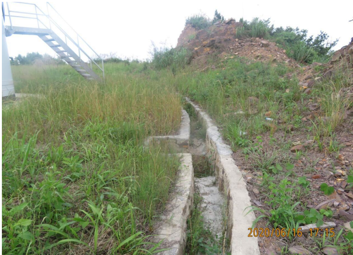
沉砂池运行情况
